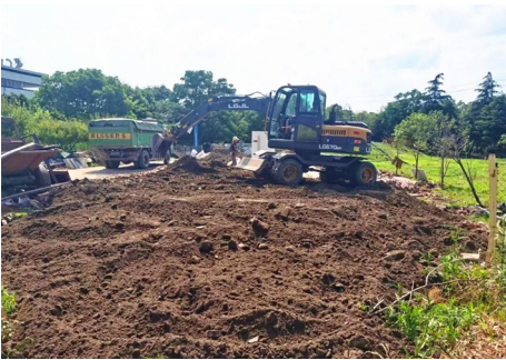
△违法用地整改现场
