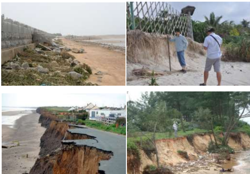
海岸侵蚀现状
